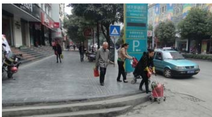
图 3 人行道斜坡设置不合理
